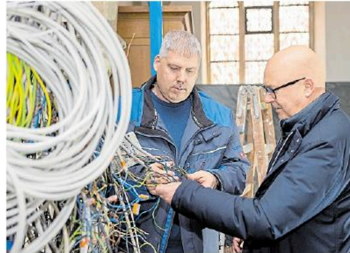
Kabelsalat im Dom Osnabrück: Elektroinstallationsmeister Carsten Krämer (links) und Sven-Andreas Sassen, Geschäftsführer der Georgsmarienhütter Firma AGW, inspizieren die Technik. Drei bis vier Kilometer Kabellänge gehen durch den Dom.
