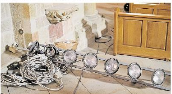
Die Beleuchtung und Elektrotechnik ist veraltet und soll erneuert werden. Das Bistum erhofft sich, die Energiekosten um etwa 20.000 Euro im Jahr zu senken.
